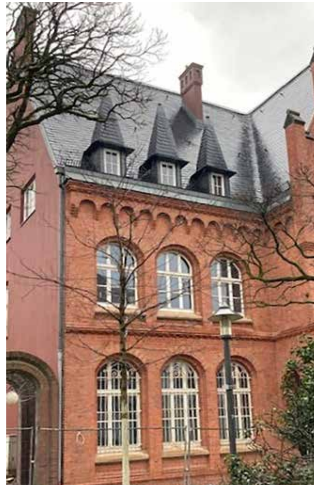
Im Rahmen der Dacharbeiten am Kulturforum Steele wurden die drei Spitzen im linken Dachbereich wiederhergestellt. Foto: Stadt Essen
